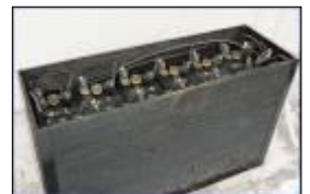
<蓄電池と収納BOX>
