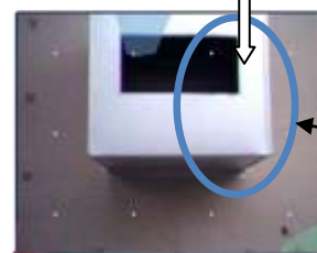
施工後のダクトの状態
